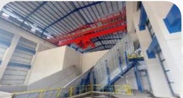
Feeder Apron SLC
